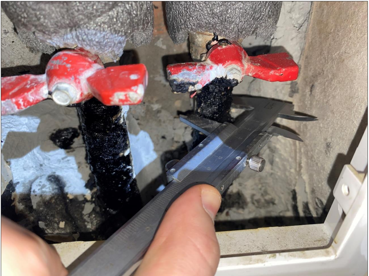
Фото 7 Разводка системы теплоснабжения
