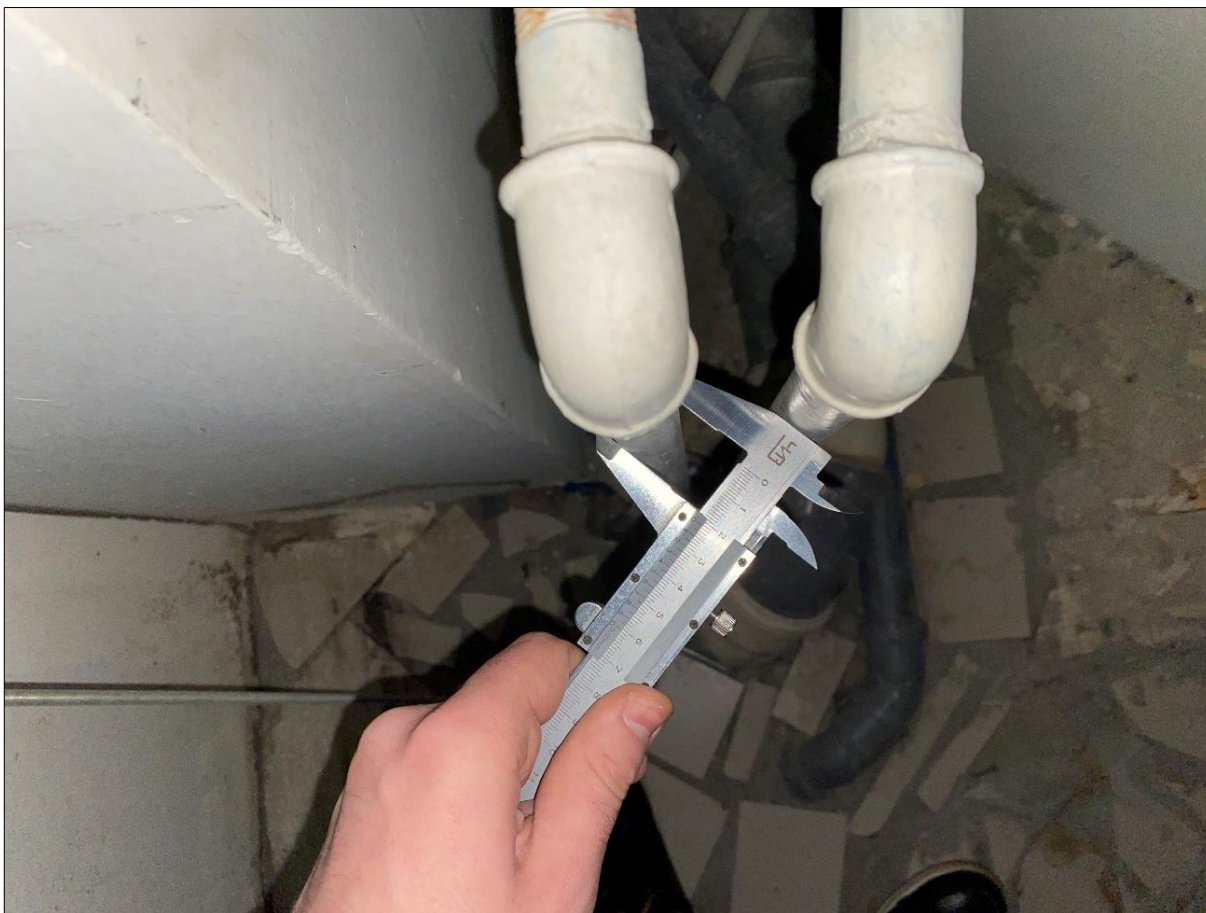
Фото 6 Разводка системы отопления
