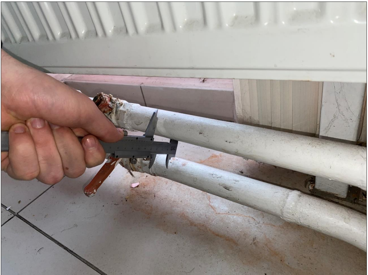
Фото 8 Разводка системы теплоснабжения
